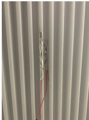
Abbildung 6: Temperatursensoren auf der Rückseite der Teilspeicherheizung (exemplarisch)
