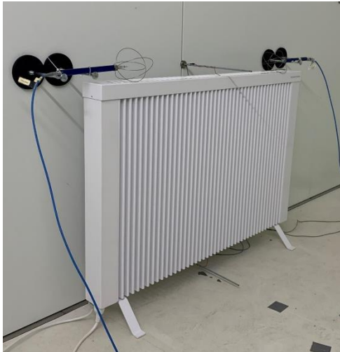
Abbildung 3: Detailansicht Teilspeicherheizung mit installierter Messtechnik
