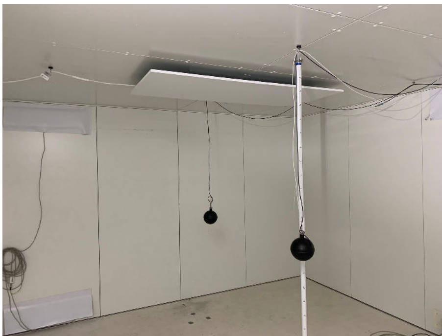
Abbildung 6: Heizgerät Infrarotheizung an der Decke – Position nah
