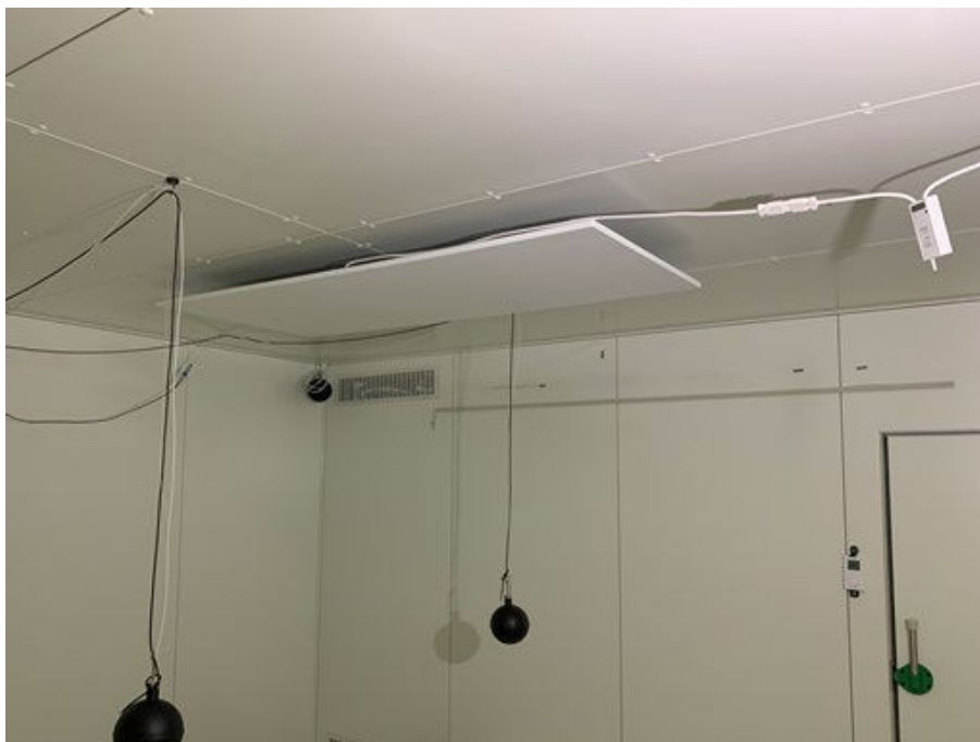
Abbildung 8: Heizgerät Infrarotheizung an der Decke – Position fern
